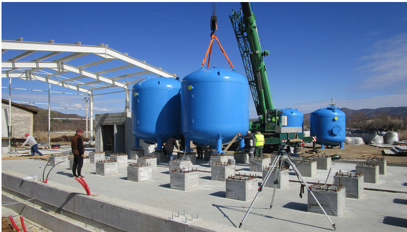
Neue Wasseraufbereitungsanlage (5'200 m 3 /d) in Trabotiviste
