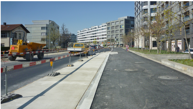
Bushaltestelle mit Schlitzrinne entlang dem Randstein Züri-Bord: ACO Drain mit Edelstahlauflauf
