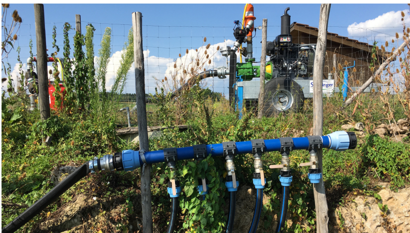
Pumpe und Verteilstation
