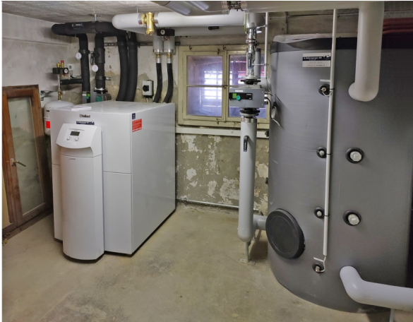
Neue EWS Wärmepumpe im Altbau anstelle Gasheizkessel
