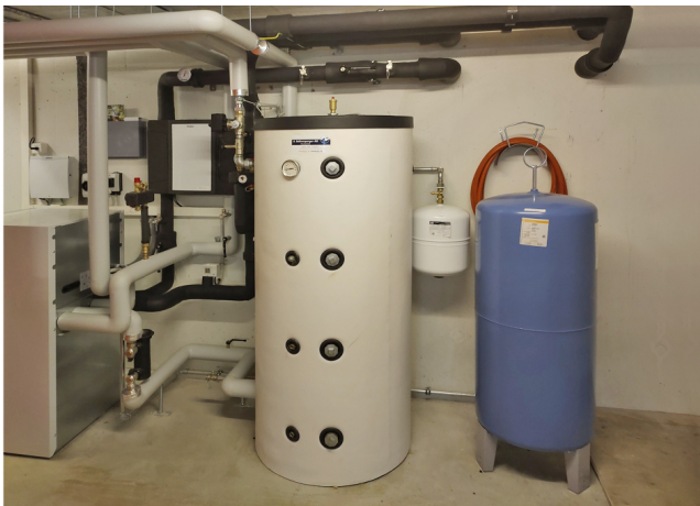
Neue EWS Wärmepumpe in Neubau
