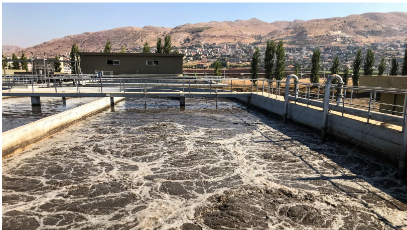
Abwasserreinigungsanlage in Jub Jannine
