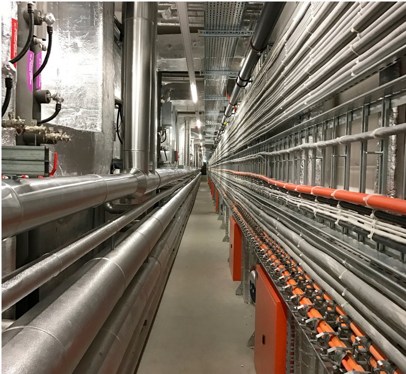
Energiekorridor PU-Mitte: Sinnbild für die engen Platzverhältnisse im Projekt
